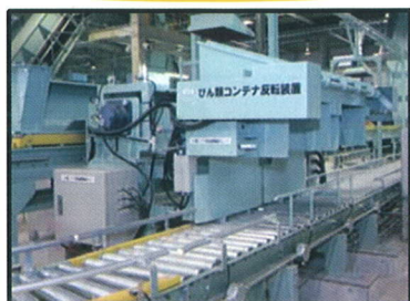
びん類供給コンベヤ・びん類反転装置
