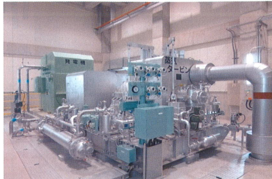
蒸気タービン発電機
