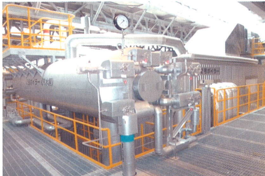
廃熱ボイラー
